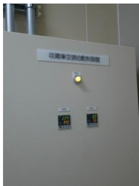
収蔵庫内温湿度管理制御盤
